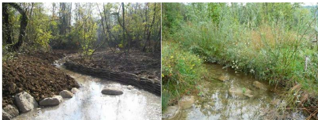
Aménagements de berges de cours d'eau, fin des travaux et après reprise de la végétation (LGV Rhin-Rhône)
